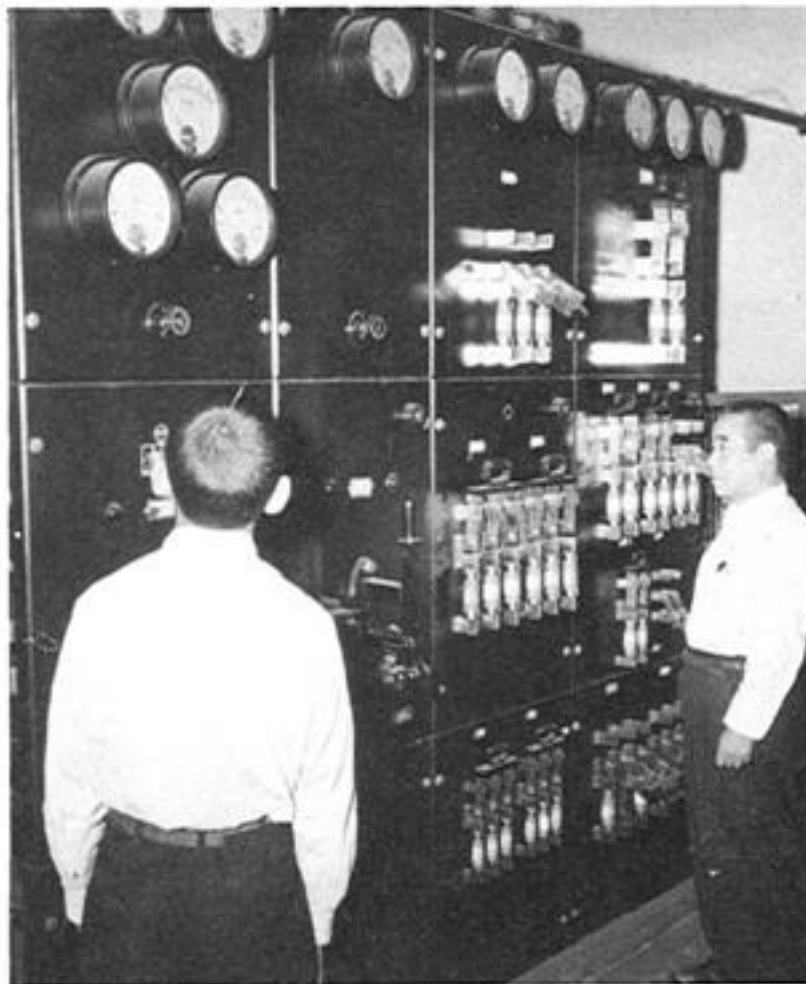
変電室での電力実験（高久先生）
